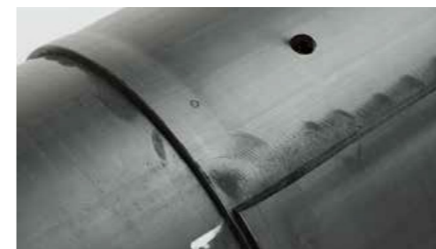
Sichtprüfung ist möglich. Ein gefülltes Loch zeigt Korrektes Schmelzen und Schweißen.
